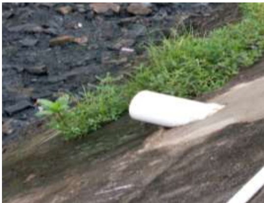
Fig. 4. Sekanak WWTP outlet
